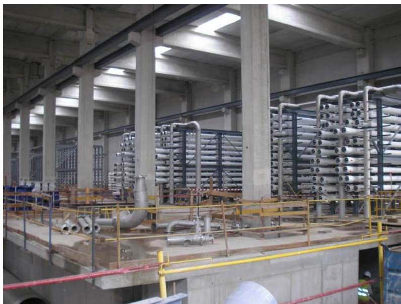
Fotografía 3 Vista general de Bastidores de Ósmosis Inversa.
