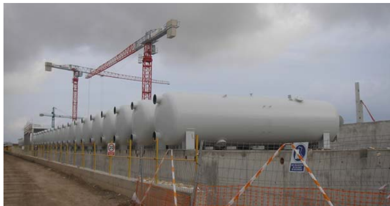
Fotografía 1 Filtros presurizados de la IDAM Águilas/Guadalentín.
